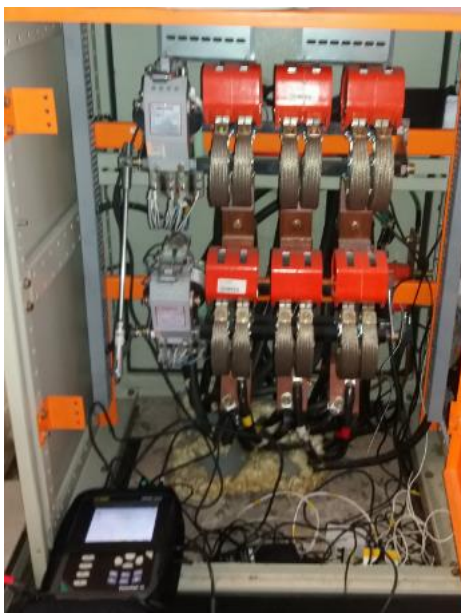
Figura 18 - AEMC 8336 ligado ao quadro de transferência automática. Fonte: Própria
