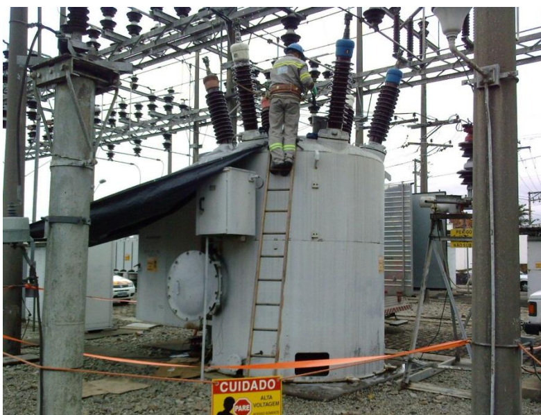
Figura 5: Disjuntor de grande volume de óleo. Fonte: Bozzi; Silva, 2011, p. 20.
