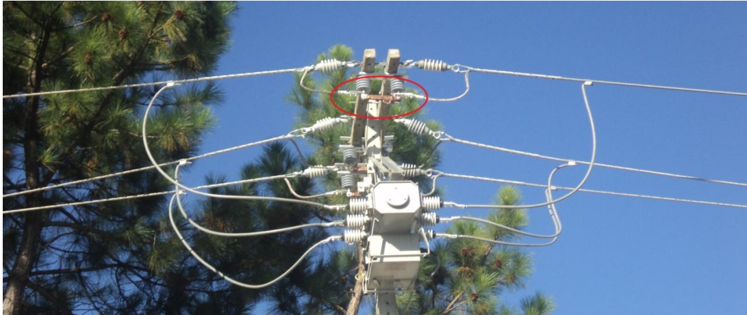
Figura 28: Detalhe da chave de by pass na instalação do Secc. Fonte: As autoras.
