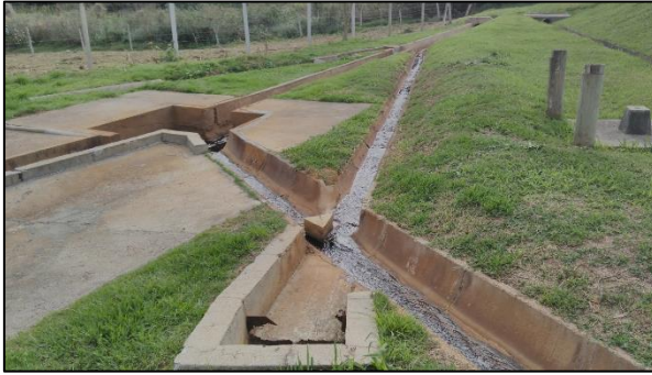
Figura 6 – Chegada do chorume à ETE
