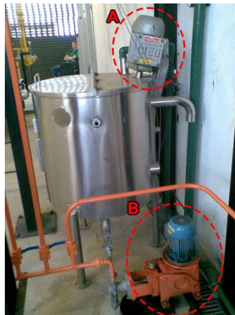
Figura 34 Bomba dosadora e tanque de mistura Autoria própria
