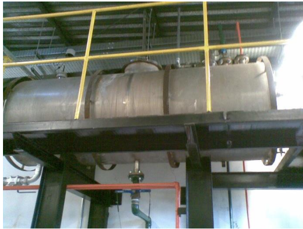
Figura 33: Tanque de alimentação de água para caldeiras Autoria própria
