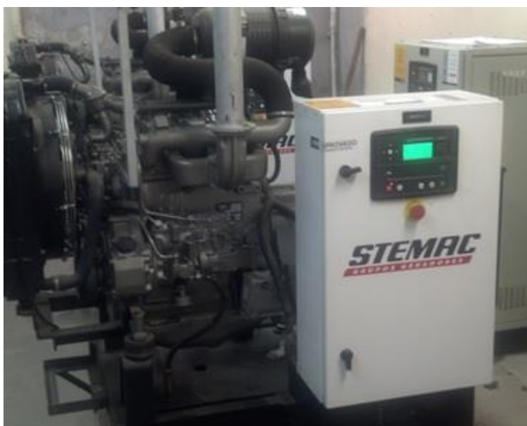
Figura 1 - Grupo Moto Gerador (GMG) Fonte: Autoria própria, 2015.
