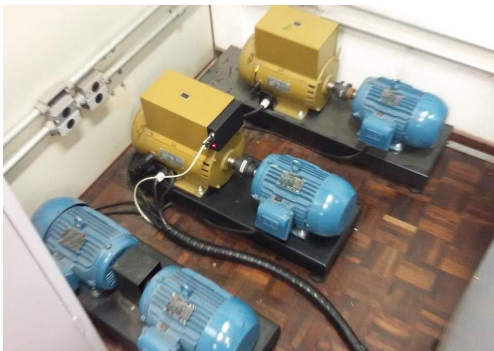
Figura 30: Geradores e motores. Fonte: Autoria própria.
