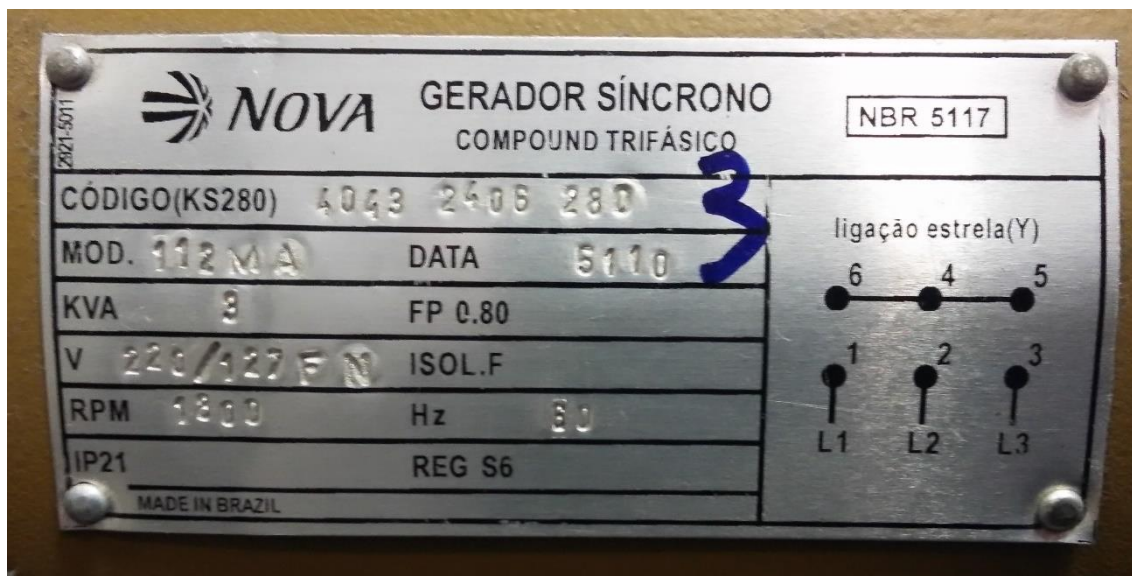
Figura 32: Placa de identificação do gerador. Fonte: Autoria própria.
