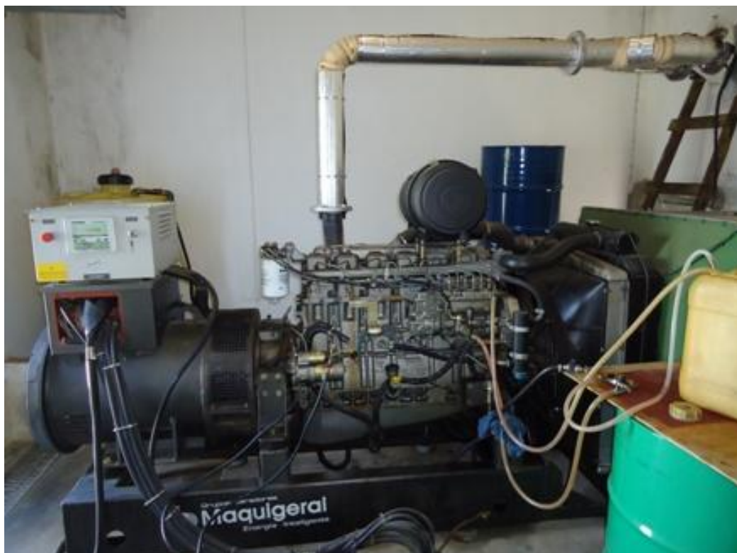
Figura 8 – Fotografia do moto gerador
