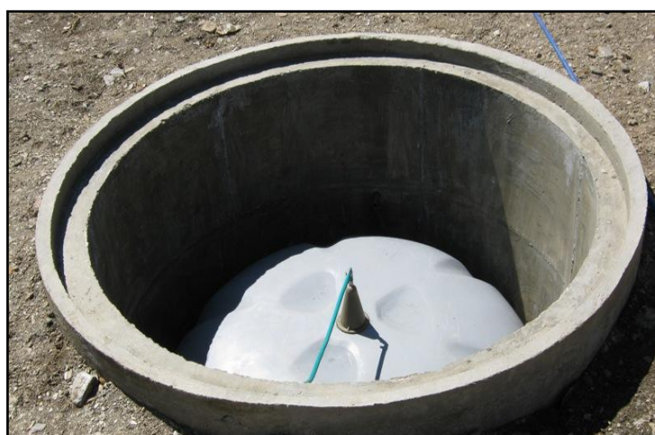
Figura 6- Foto: Biodigestor de biogás instalado em Ermera
