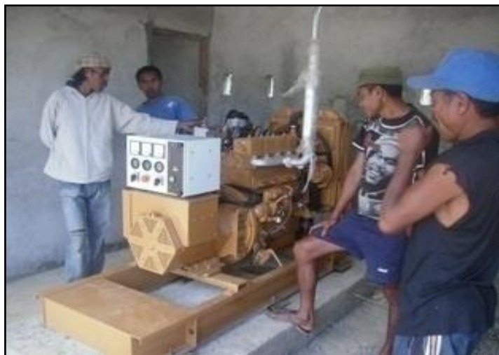
Figura 7– Foto: Gerador a biogás instalado em Ermera Fonte: SEPE, 2009
