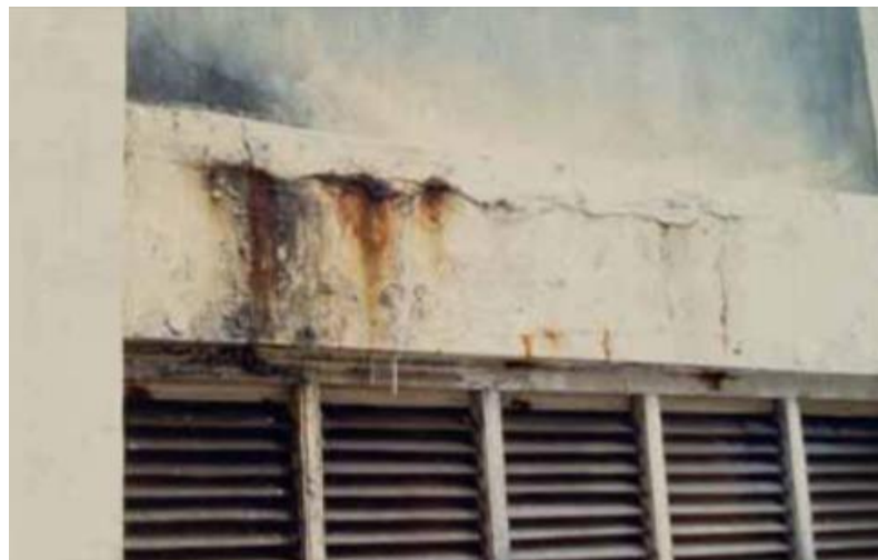
Figura 8 - Desagregação do concreto
