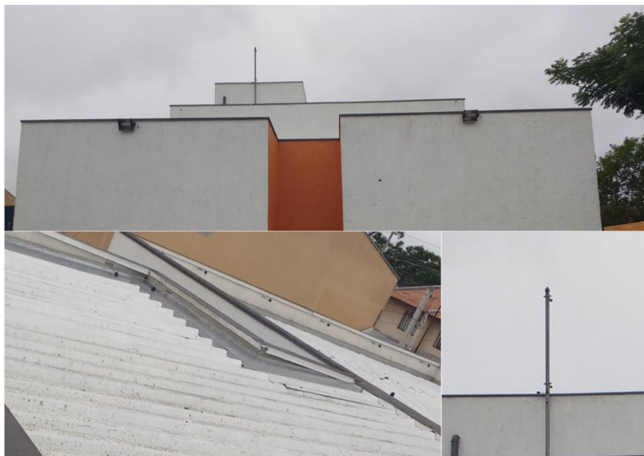
Figura 39 - Instalação de para-raios incompleta Fonte: Autoras.
