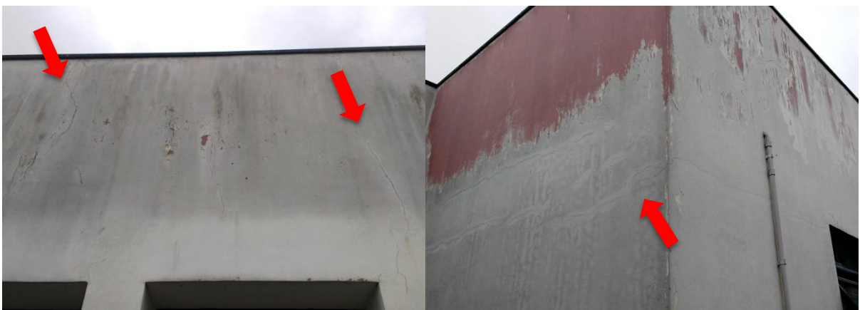
Figura 21 - Fissuração por variação térmica Fonte: Autoras.
