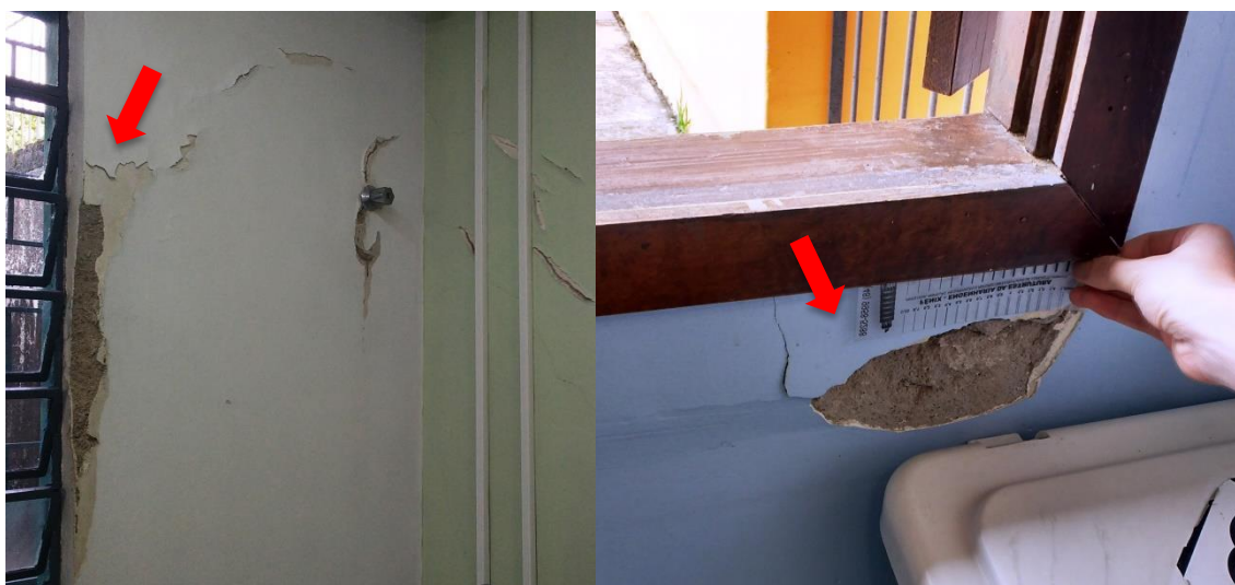
Figura 26 - Desagregação por falha construtiva Fonte: Autoras.
