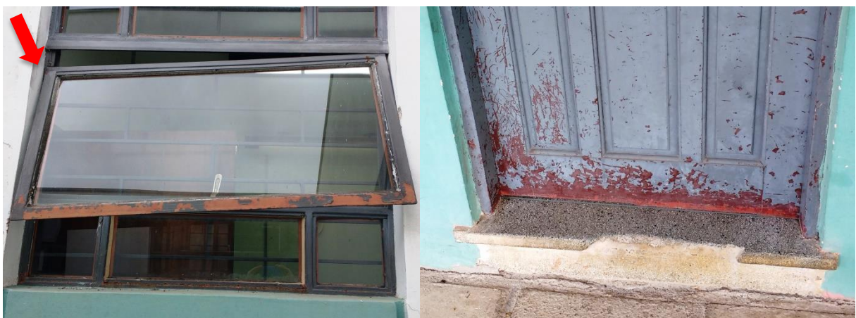
Figura 33 - Deterioração de portas e janelas Fonte: Autoras.
