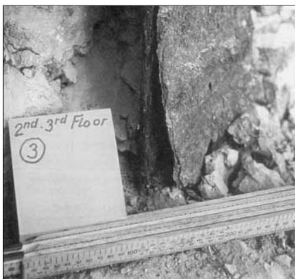
Figura 15 - Lâmina oxidada se desprendendo do aço Fonte: The Institution of Structural Engineers (2010).
