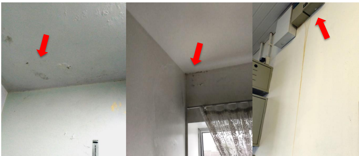
Figura 30 - Infiltração por impermeabilização inadequada
