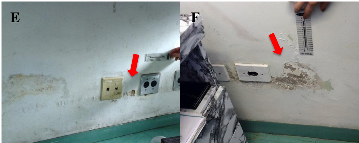
Figura 29 - Umidade ascendente: (A) e (B) bolhas de umidade, (C) e (D) manchas e bolor, (E) e (F) umidade próxima à tomadas
