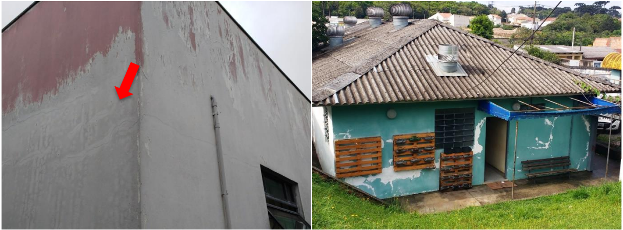
Figura 32 - Deterioração do revestimento interno e externo Fonte: Autoras.
