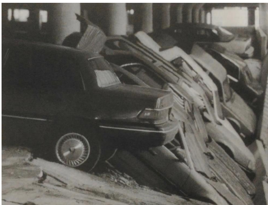
Figura 13 - Ruína da estrutura de um estacionamento contaminada por sal de degelo
