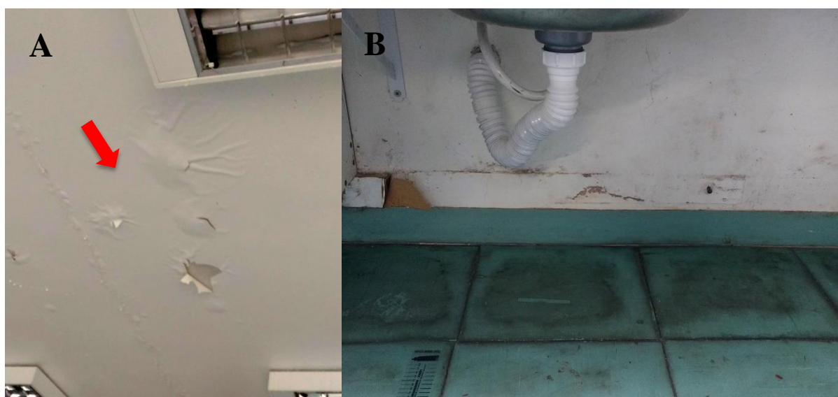
Figura 31 - Infiltração por vazamento acidental: (A) bolhas no teto e (B) vazamento da pia Fonte: Autoras.
