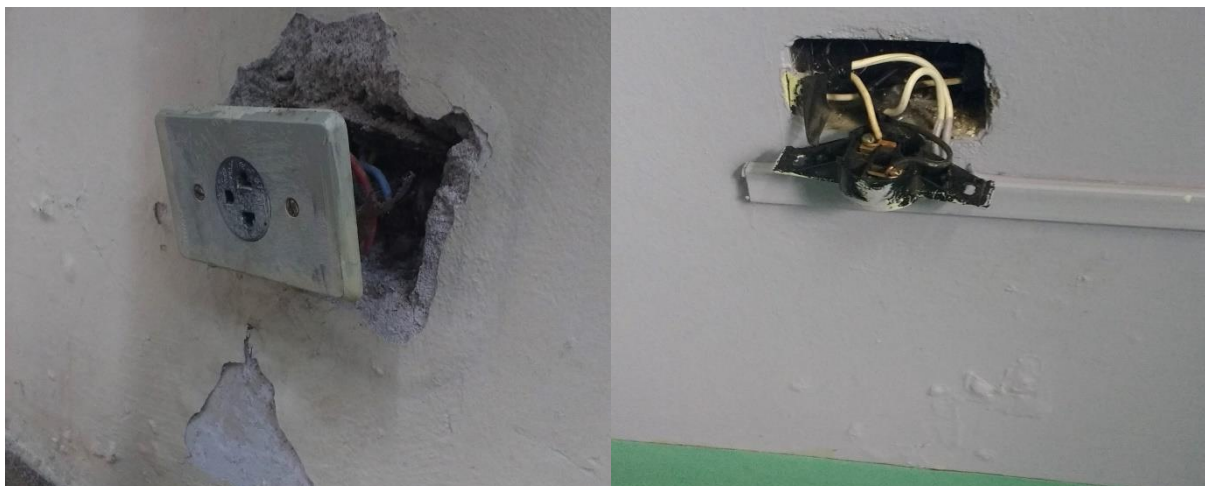
Figura 35 - Fiação exposta Fonte: Autoras.
