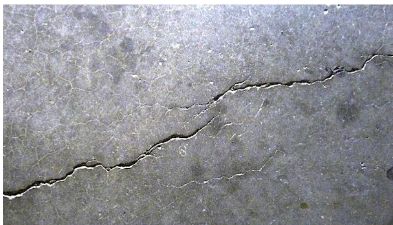
Figura 6 - Fissura em elemento de concreto Fonte: International Association of Certified Home Inspectors (2017).
