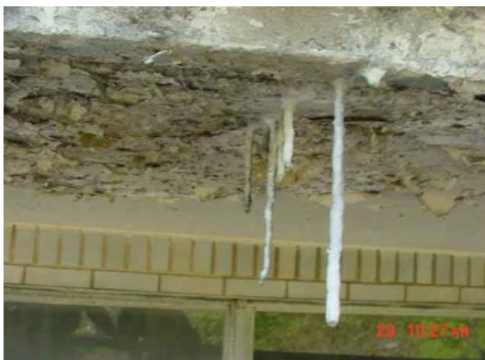
Figura 10 - Formação de estalactites no concreto Fonte: Building Enclosure Consulting (2017).
