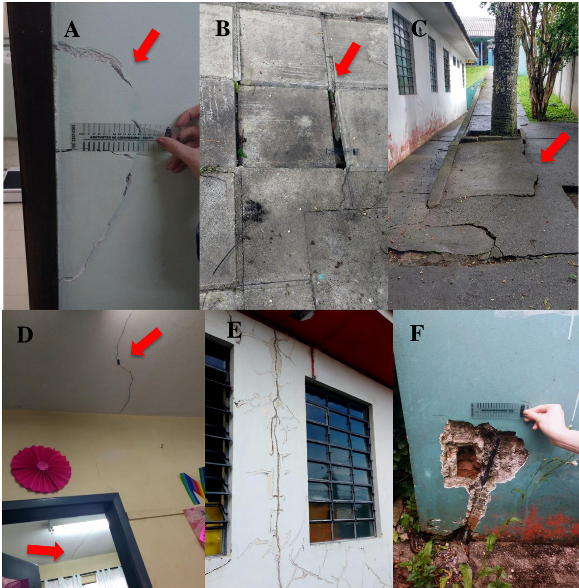
Figura 37 - Falha construtiva: (A) trincas no batente da porta, (B) e (C) calçadas deterioradas, (D) e (E) compactação insuficiente do solo, (F) má execução de cano na parede Fonte: Autoras.
