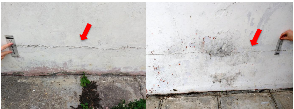
Figura 25 - Fissuração por umidade Fonte: Autoras.
