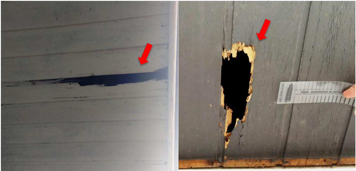
Figura 34 - Deterioração do forro Fonte: Autoras.
