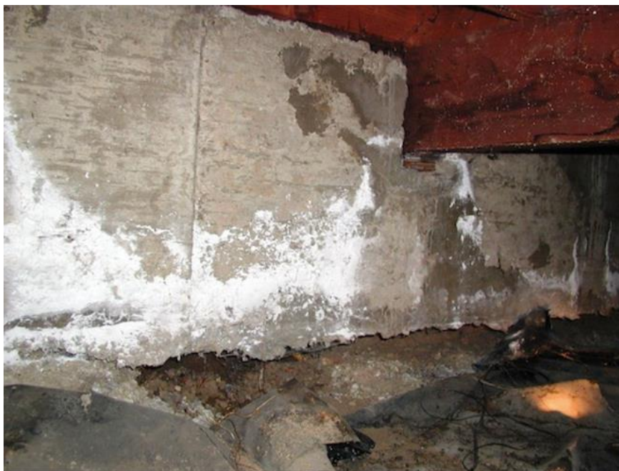
Figura 11 - Elemento de fundação com eflorescência severa Fonte: International Association of Certified Home Inspectors (2017).
