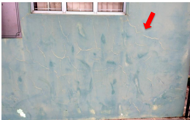
Figura 22 - Fissuração por retração da argamassa de revestimento Fonte: Autoras.
