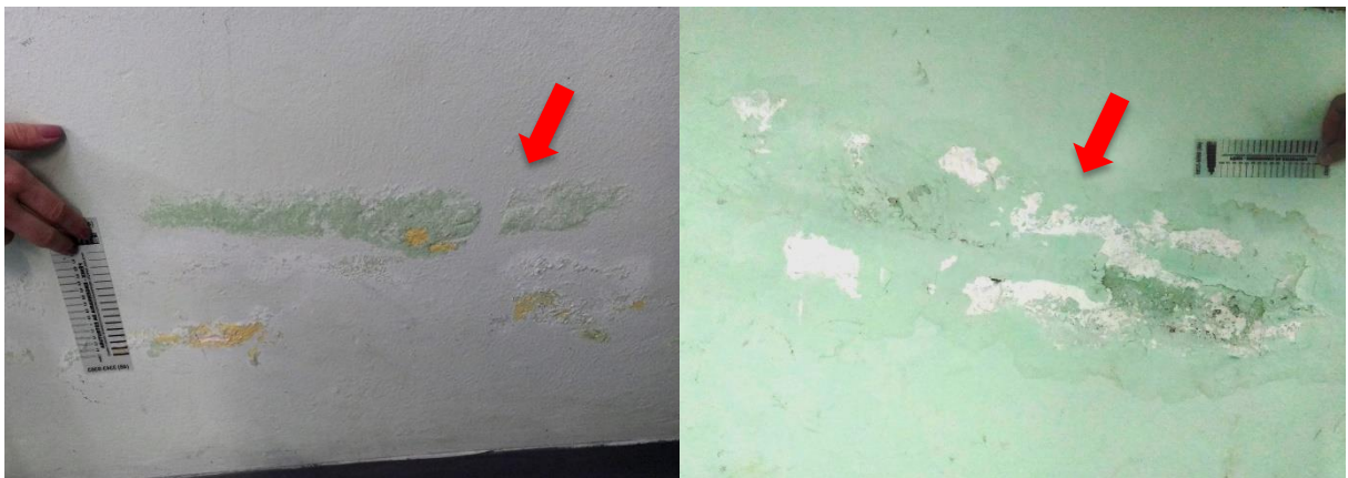
Figura 28 - Eflorescência Fonte: Autoras.
