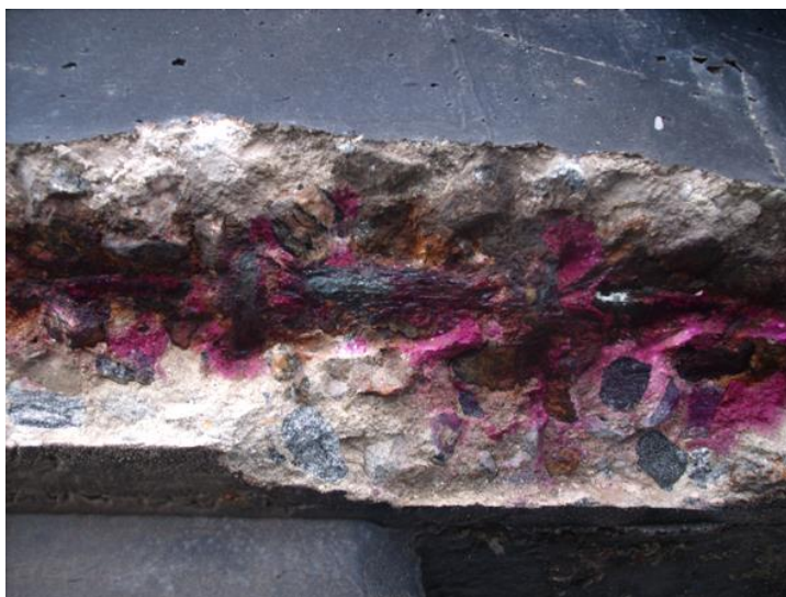
Figura 12 - Ensaio de carbonatação no concreto Fonte: IPT (2017).
