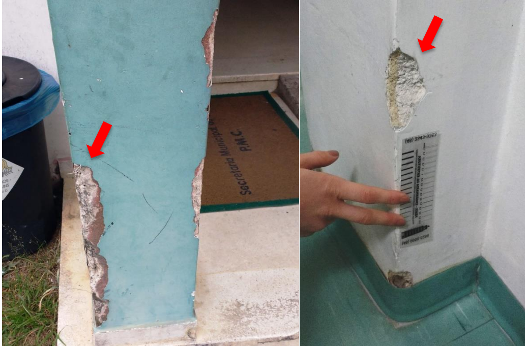
Figura 27 - Desagregação acidental Fonte: Autoras.
