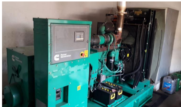
Figura 12 - Gerador à Diesel em Operação
