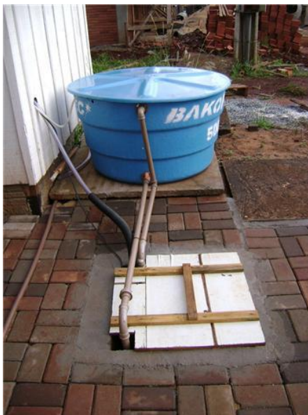
Figura 4. Tanque de equalização
