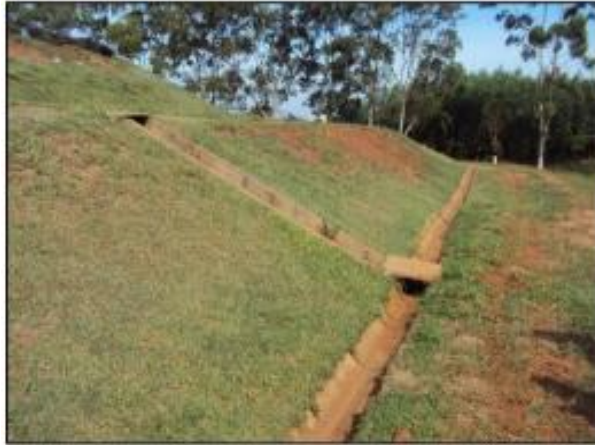
Figura 14 – Sistema de drenagem de água da chuva no Aterro Sanitário do município 2. Fonte: ALVES (2015).
