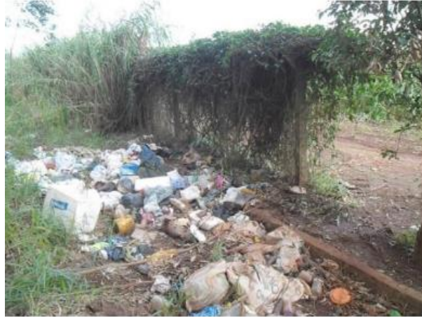
Figura 13 – Cerca danificada do entorno do Aterro Controlado do município 3.
