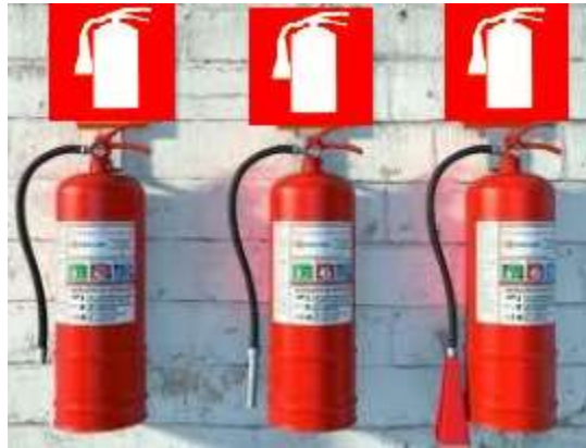
Figura 5-6 – Extintor sinalizado (Autoria própria)
