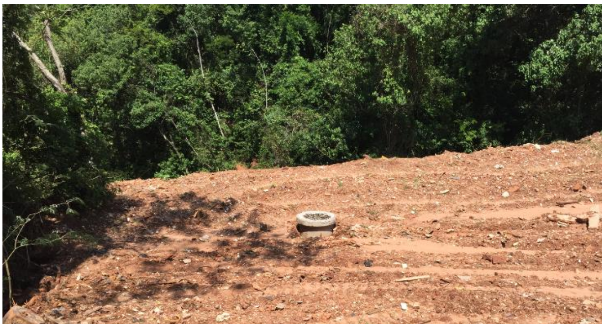
Figura 5 - Tubo de concreto para captação de águas pluviais.
