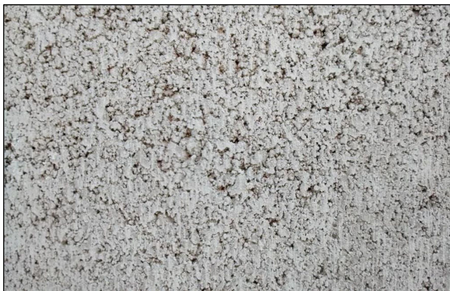
Figura 26 – Textura superficial bloco vedação empresa A Fonte: Autoria própria.
