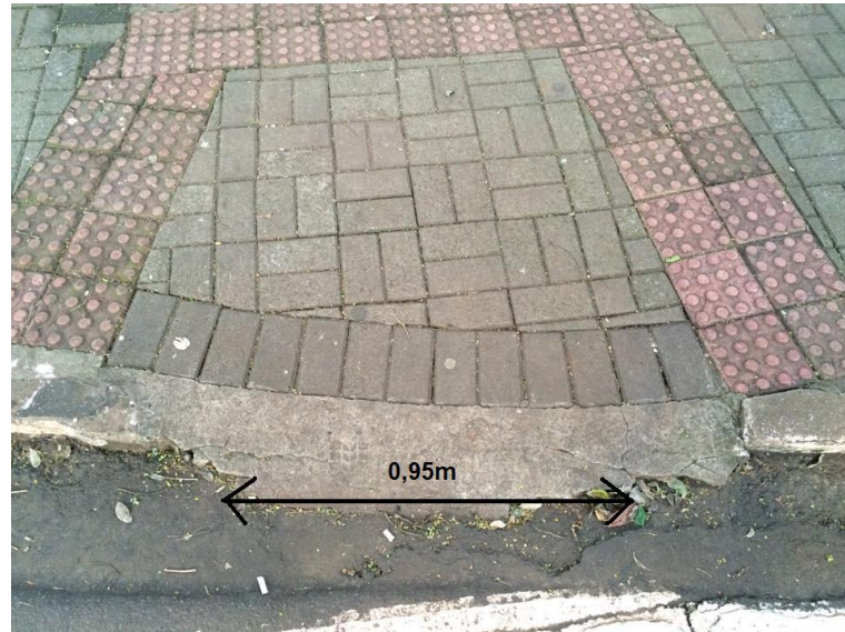
Figura 50 – Rebaixamento de guia com largura inapropriada Fonte: foto tirada pelo autor
