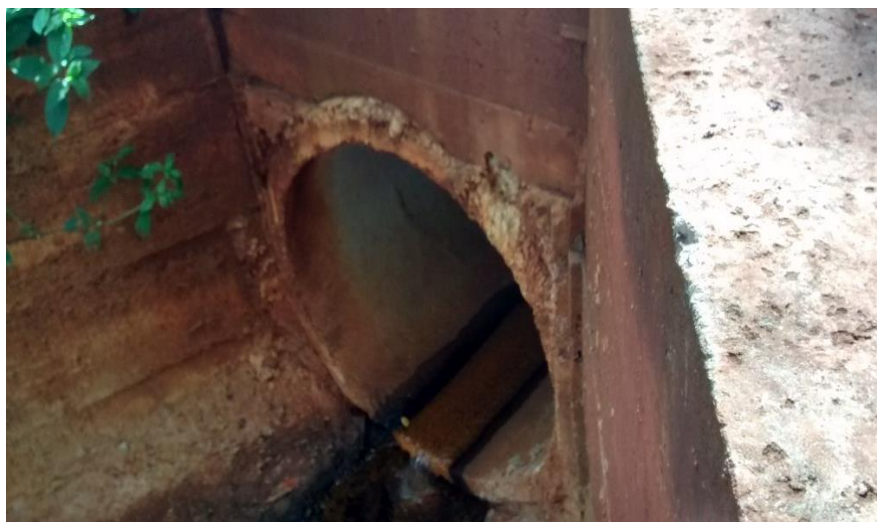
Figura 31 - Saída do emissário 5 Fonte: Autoria própria (2016)
