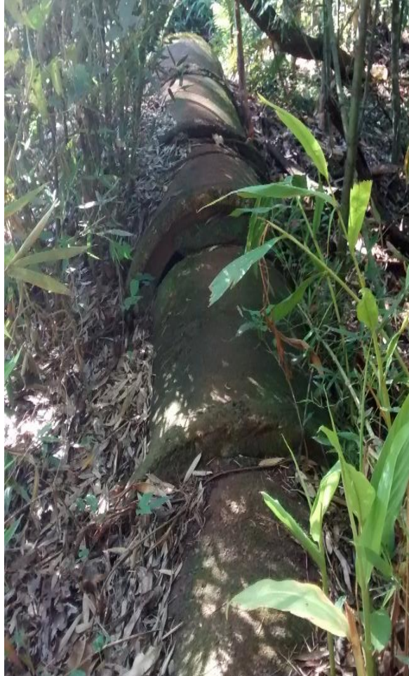
Figura 21 - Tubulação apresentando rachaduras Fonte: Autoria própria (2016)
