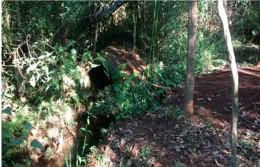
Figura 22 - Saída do emissário, ausente a presença de estrutura de dissipação de energia Fonte: Autoria própria (2016)
