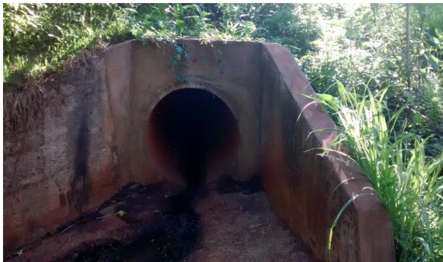
Figura 25 - Saída do emissário 2, presença de afluyente escuro
