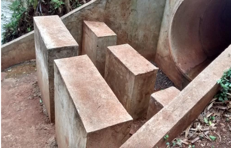
Figura 34 - Saída do emissário 5 com a presença de grandes dissipadores de energia Fonte: Autoria própria (2016)
