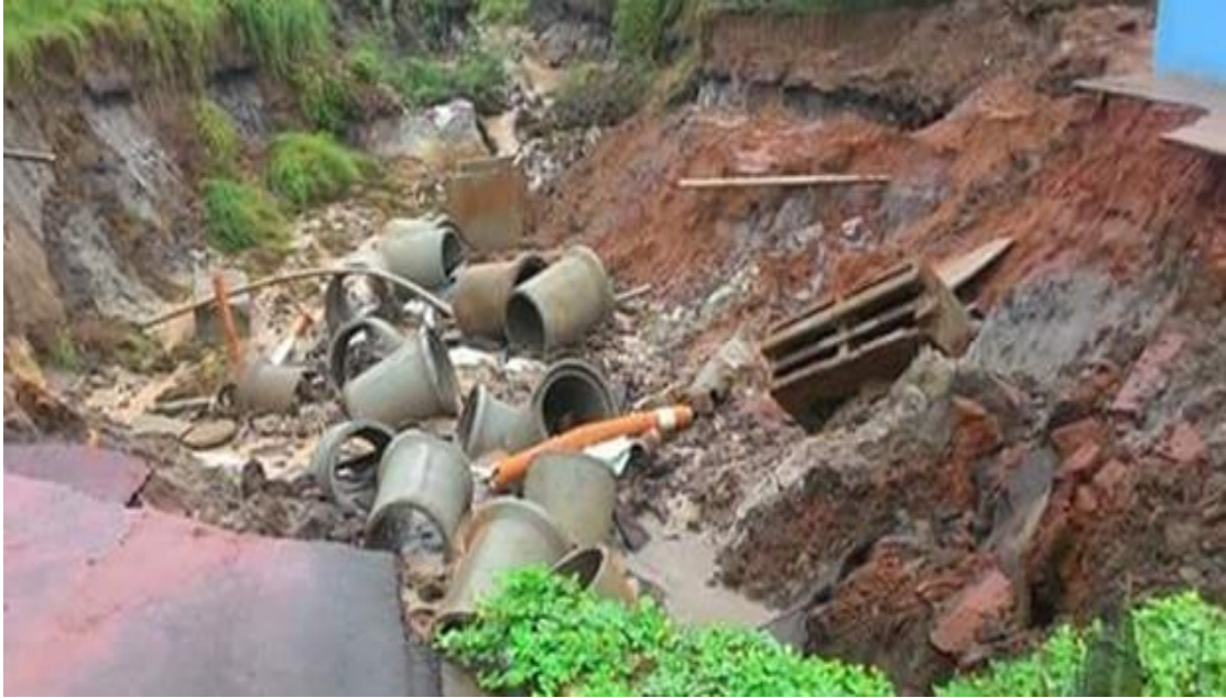
Figura 6 – Desbarrancamento e erosão devido a precipitação excessiva, os componentes da tubulação de galeria de águas pluviais ficou aparente
