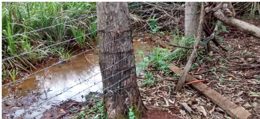
Figura 42 - Água parada no entorno do emissário 8
