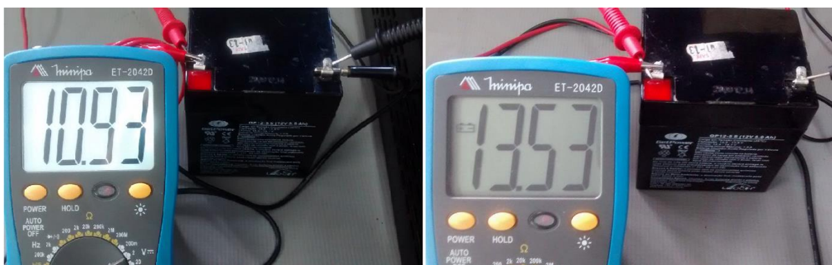
Figura 38 – Tensão na Bateria no Início e no Fim do Processo de Carga Fonte: Autoria Própria.
