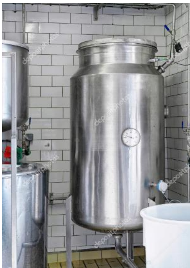
Figura 11 – Tanque de armazenamento.
