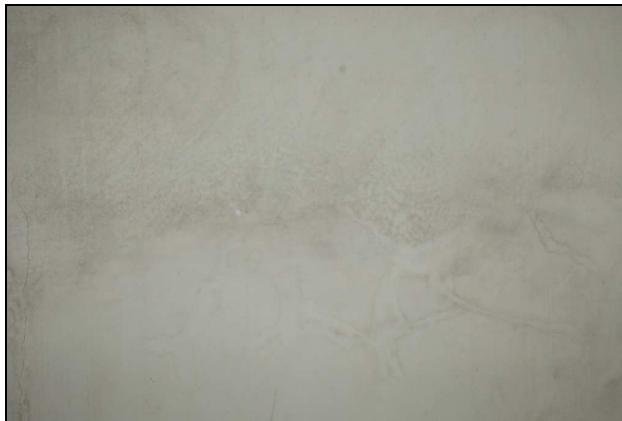
Figura 15 – Mancha na pintura interna.
