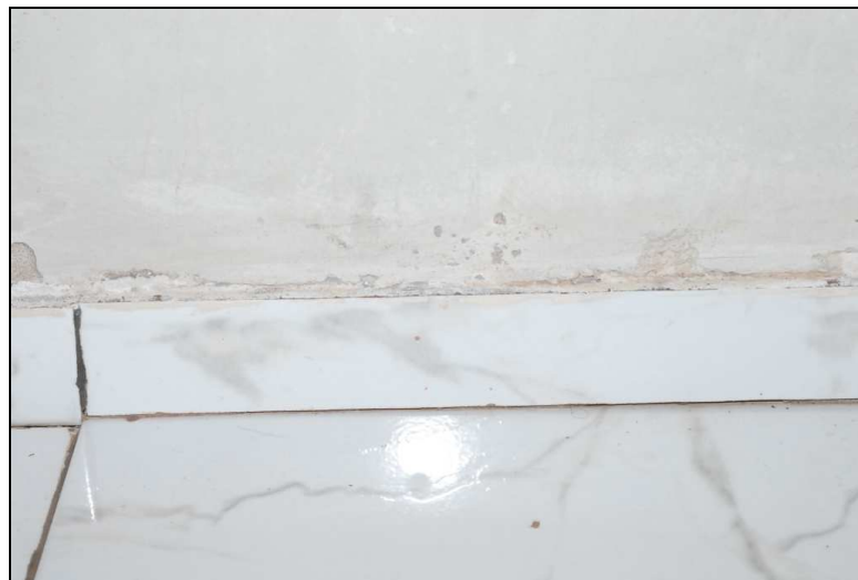
Figura 8 – Umidade por capilaridade.
