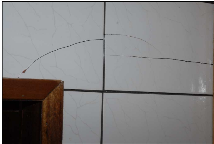
Figura 11 – Fissura no revestimento cerâmico interno.
