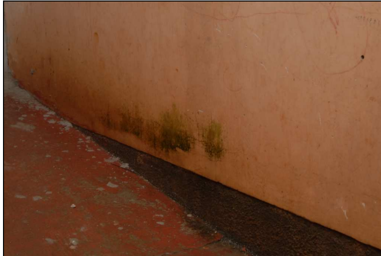
Figura 9 – Mancha na pintura externa (umidade).
