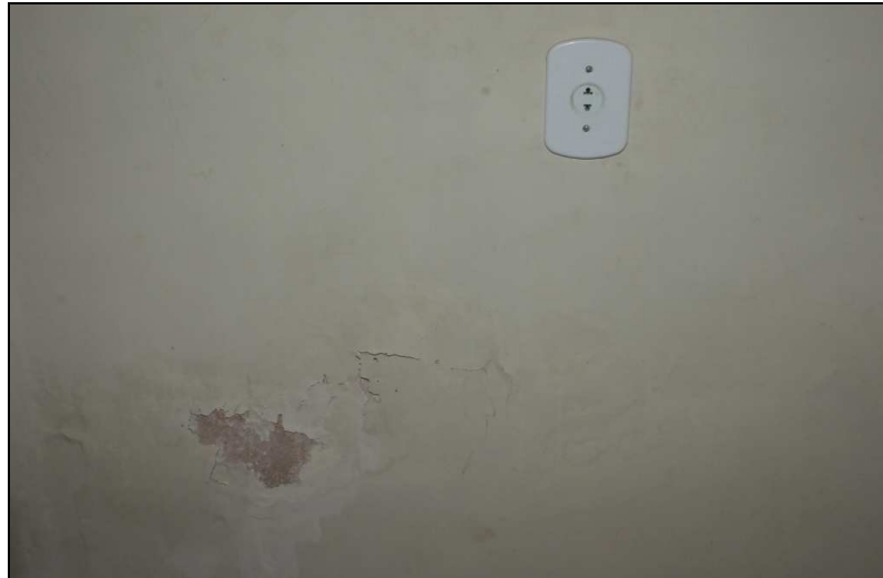
Figura 7 – Descolamento da pintura interna (umidade).
