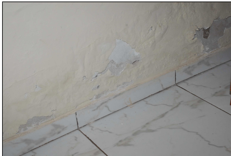
Figura 6 – Umidade por capilaridade.
