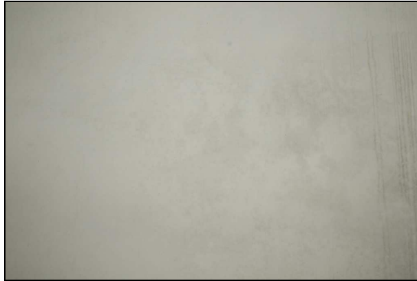
Figura 14 – Manchas na pintura interna.
