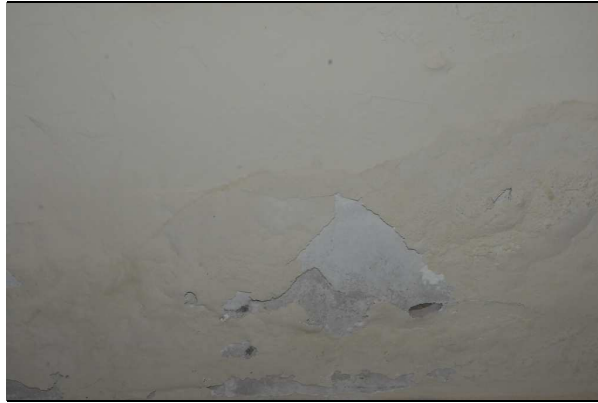
Figura 16 – Descolamento da pintura externa.
