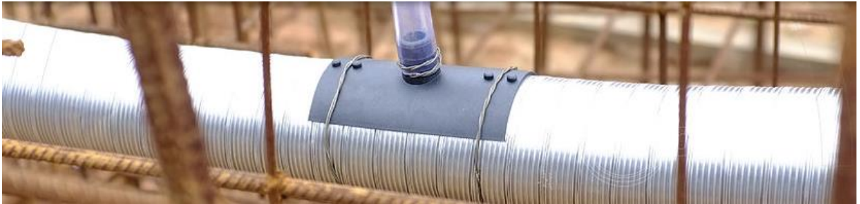
Figura 8: Purgador conectado à bainha metálica Fonte: COPLAS (2019).
