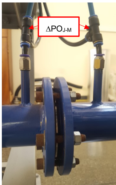
Fotografia 6 - Medidor de vazão de ar tipo placa de orifício
