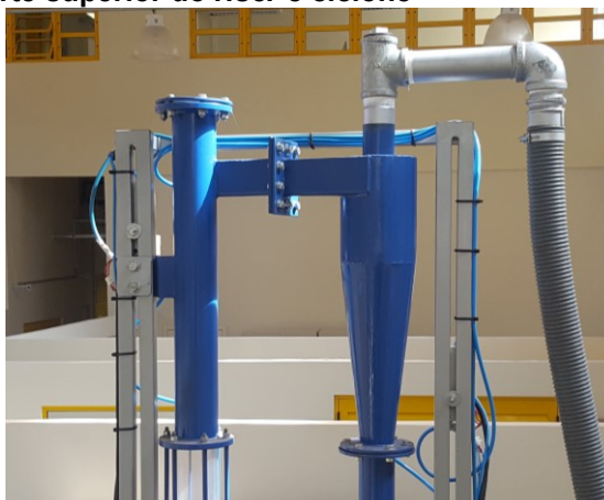
Fotografia 3 - Parte superior do riser e ciclone
