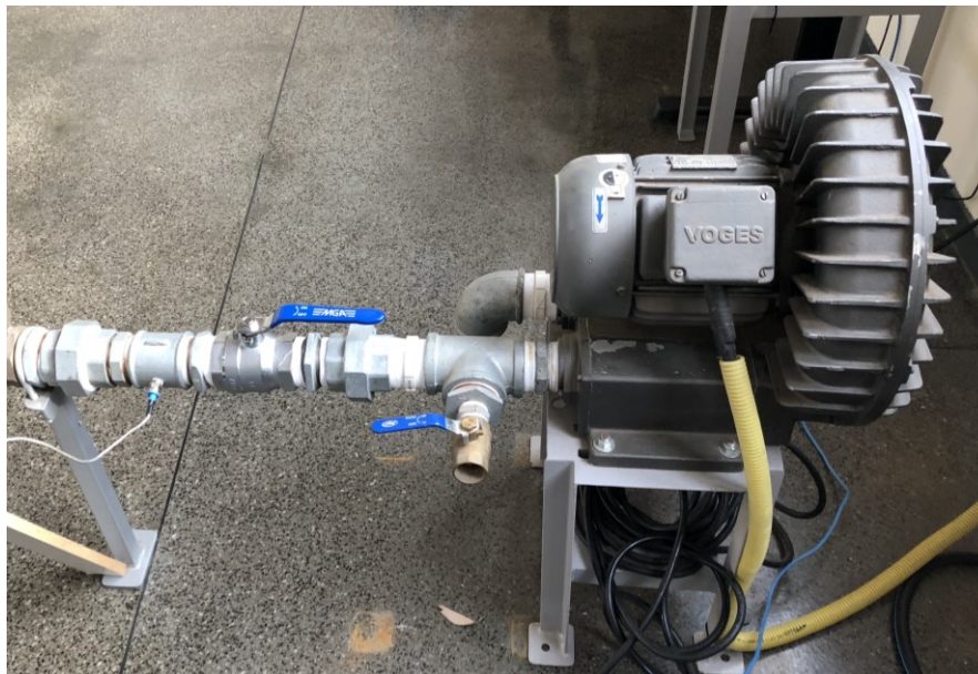
Fotografia 5 - Soprador, by-pass , válvula globo e sensor de temperatura PT-100
