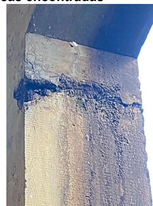
Degradação do concreto de pilares
