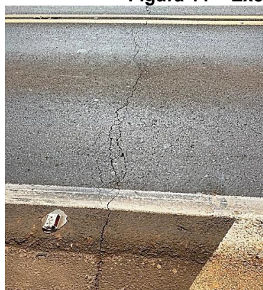
Fissura no pavimento
