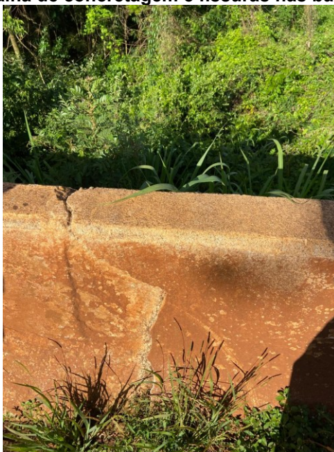
Figura 15 - Falha de concretagem e fissuras nas barreiras rígidas
