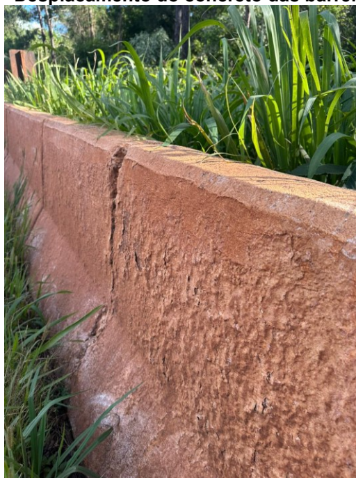
Figura 17 - Deslocamento do concreto das barreiras rígidas
