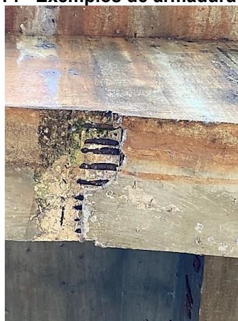
Figura 14 - Exemplos de armadura exposta
