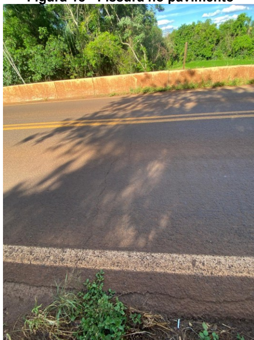
Figura 18 - Fissura no pavimento
