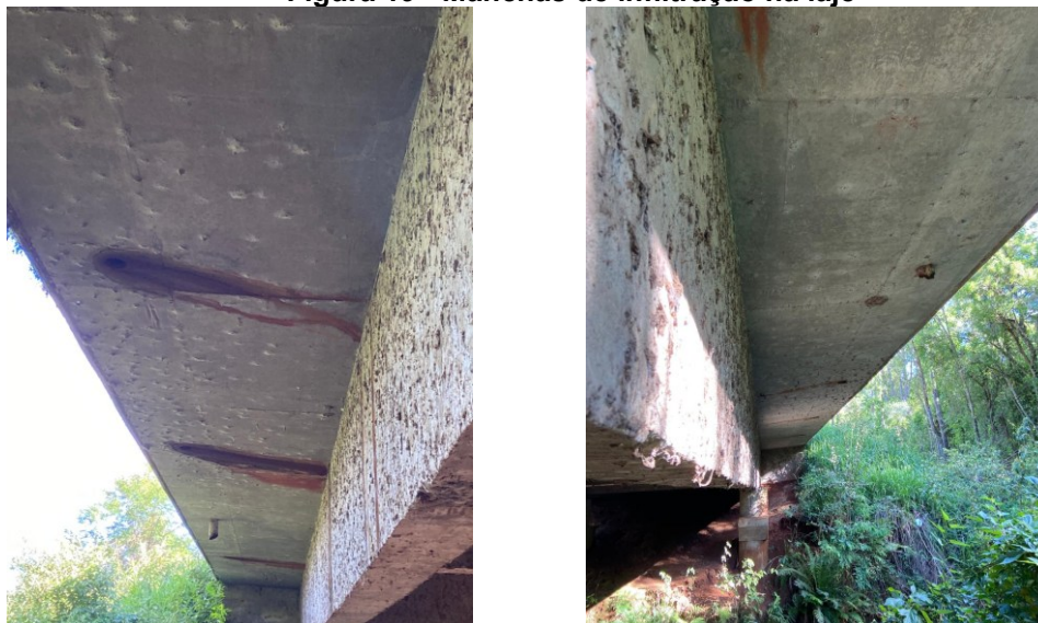
Figura 19 - Manchas de infiltração na laje
