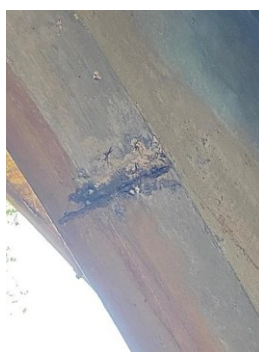
Mancha de oxidação
