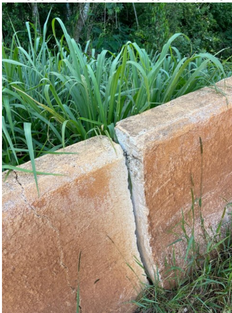
Figura 16 - Fissura e deslocamento nas barreiras rígidas
