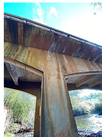
Mancha de umidade em laje
