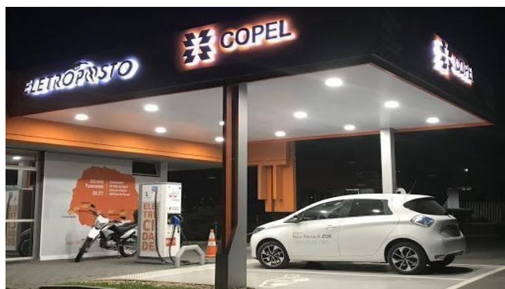
Figura 2 - Eletroposto da eletrovia COPEL de Paranaguá a Foz do Iguaçu
