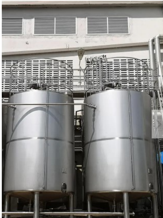
Figura 18 – Tanque de armazenamento.
