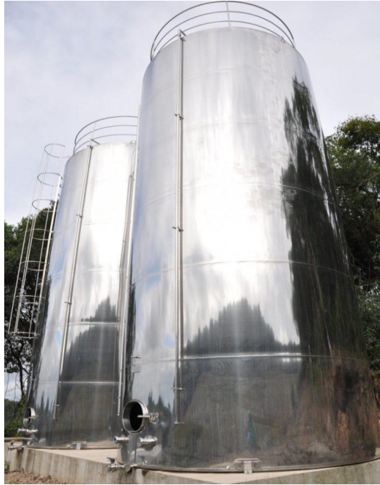
Figura 8 - Tanque de armazenagem em aço inox.
