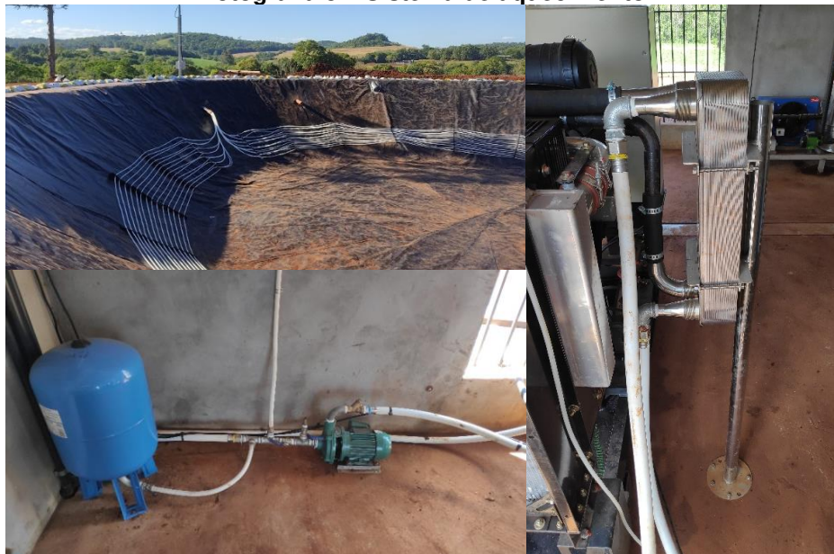
Fotografia 8 – Sistema de aquecimento
