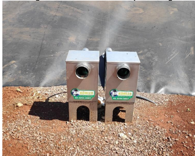
Fotografia 6 – Sistema de escape de biogás
