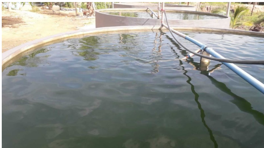
Figura 12 - Oxigenação por ar difuso em tanque de ferro cimento
