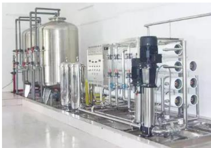
Figura 22 - Sistema de osmose reversa
