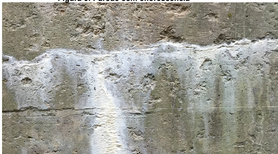
Figura 3: Parede com eflorescência
