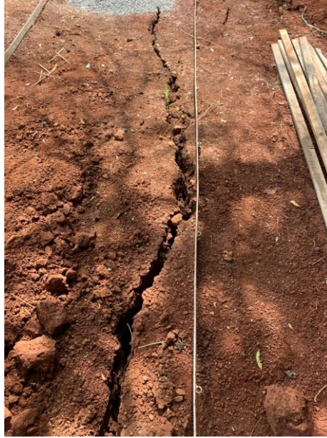
Fotografia 2 – Rachaduras na crista do talude de aterro em Guarapuava/PR
