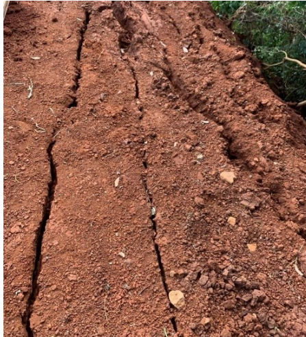
Fotografia 1 - Rachaduras na crista do talude de aterro em Guarapuava/PR
