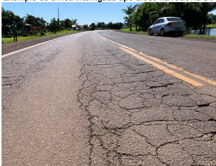
Figura 3 – Exemplo de trinca interligada tipo bloco na rodovia SC-163
