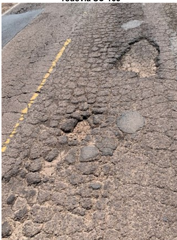
Figura 18 – Exemplo de defeitos existentes em estação inventariada no trecho de estudo da rodovia SC-163
