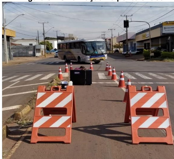
Figura 8 – Sinalização no ponto crítico 1
