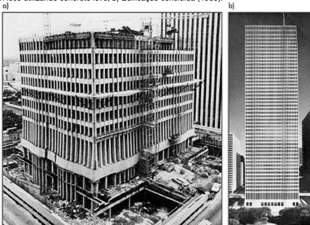
Figura 26 - Edifício Shell Plaza 1 (Houston, Estados Unidos): a) Execução integral da estrutura moldada in loco utilizando concreto leve; b) Edificação concluída (1969).
