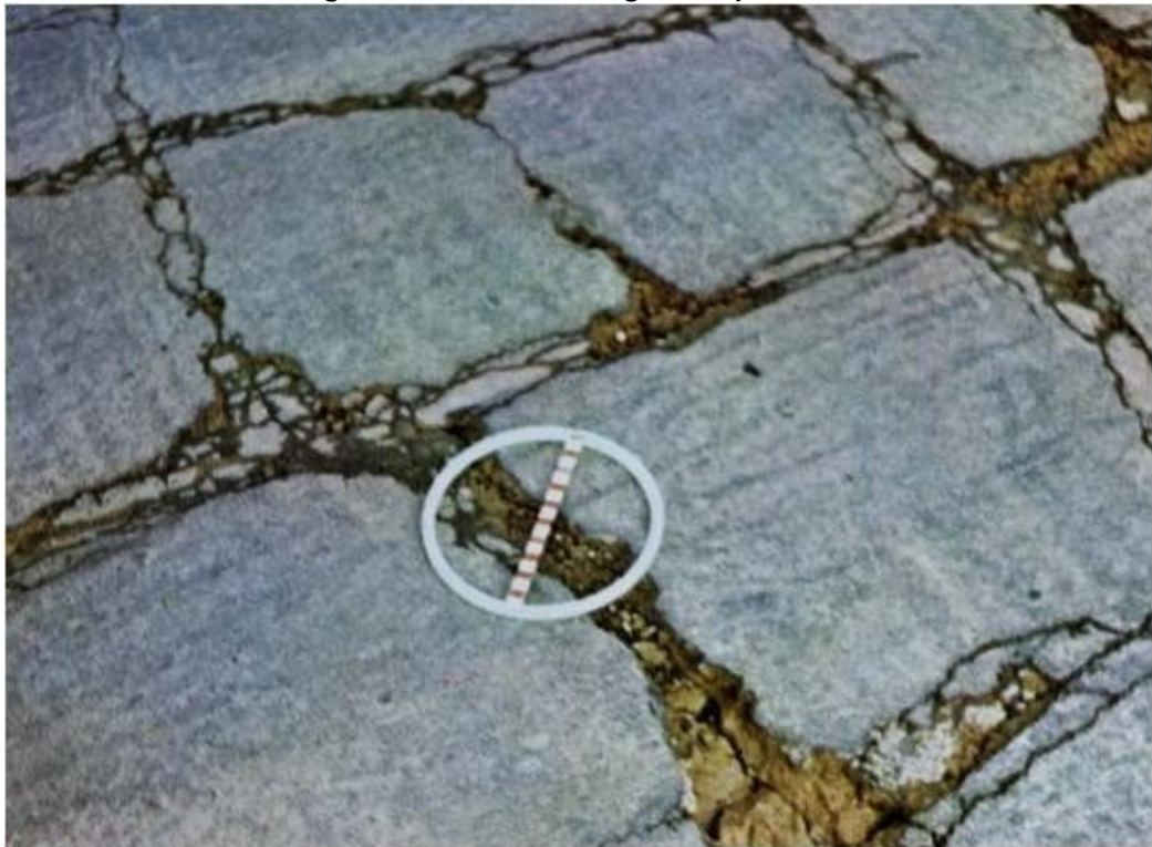
Figura 5 - Trincas Interligadas tipo Bloco
