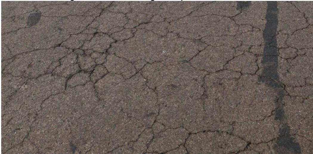
Figura 4 - Trincas Interligadas tipo Couro de Jacaré
