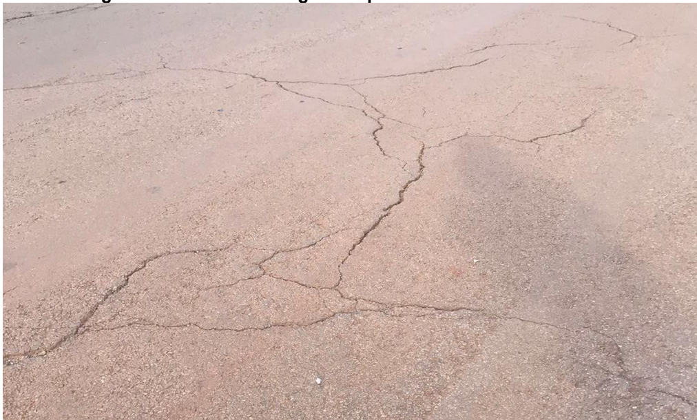
Figura 16 - Trincas interligadas tipo "bloco" nas vias avaliadas
