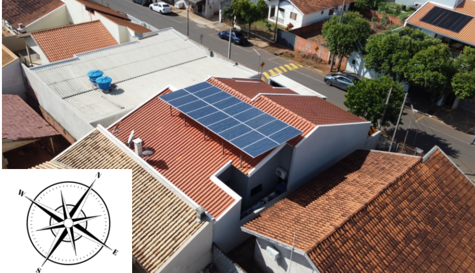
Fotografia 2- Localização dos módulos fotovoltaicos – edificação urbana
