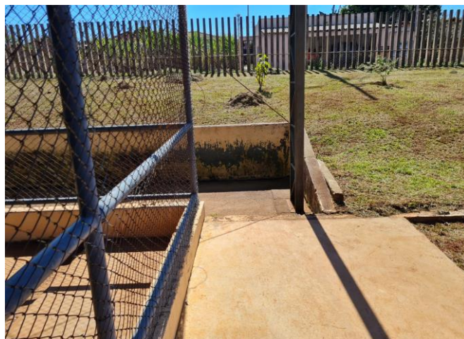
Fotografia 29 – Desnível para Acesso a Quadra de Esportes
