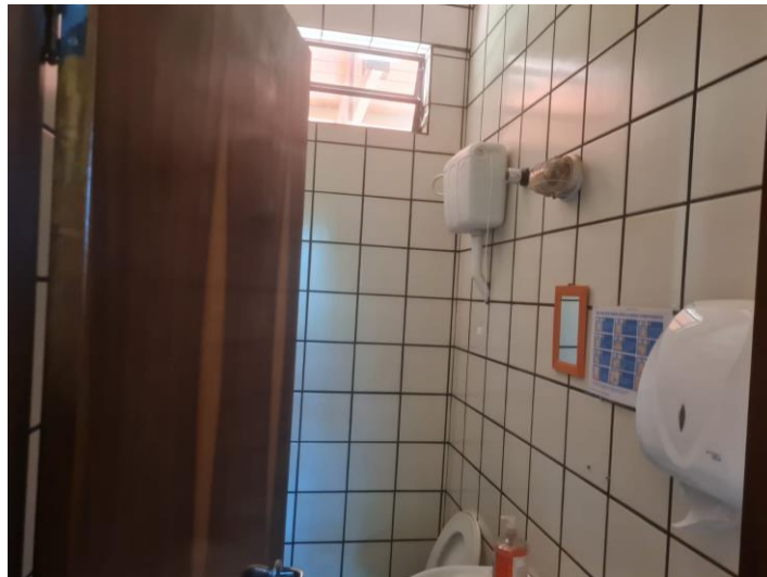
Fotografia 15 – Descarga Banheiro dos Professores
