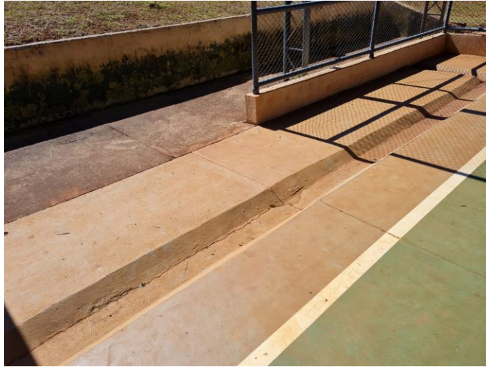
Fotografia 32 – Canaleta na Quadra de Esportes
