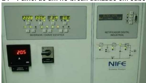
Figura 24 – Painel de um no-break utilizado em subestações
