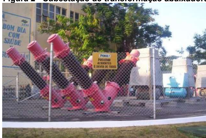
Figura 2 - Subestação de transformação abaixadora
