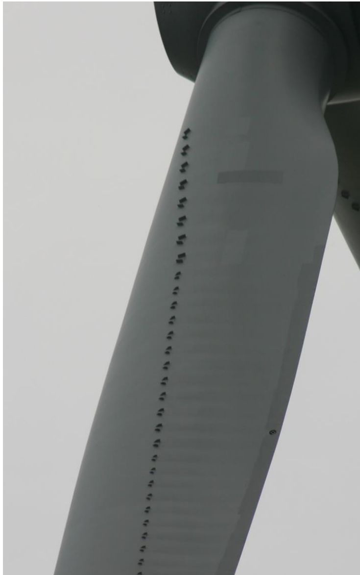
Figura 2 - Geradores de vórtice instalados em uma turbina Südwind S 70 1,5 kW
