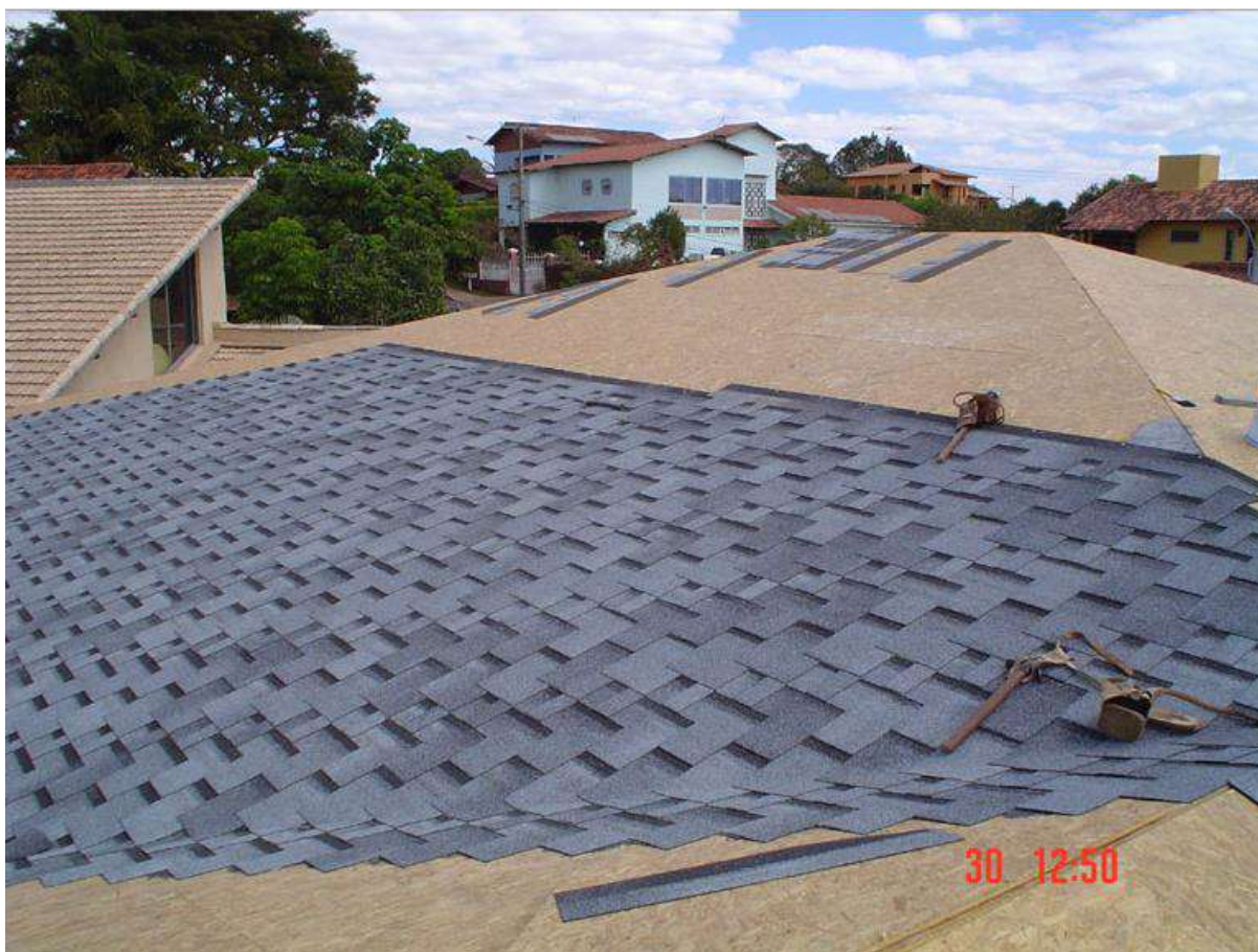
Figura 12: Utilização de placas de OSB para o telhado com telhas shingle . Fonte: TC SHINGLE, 2004.
