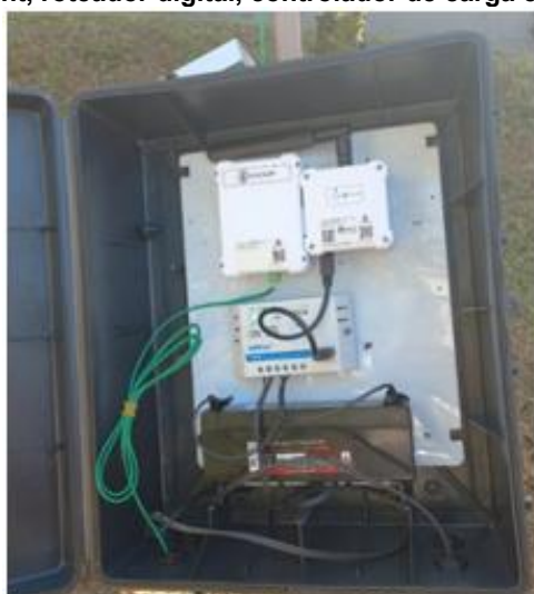
Figura 7 – Endpoint, roteador digital, controlador de carga e bateria instalados
