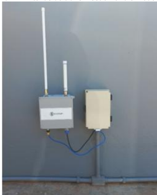
Figura 4 – Antenas de transmissão LoRa e modem 3G
