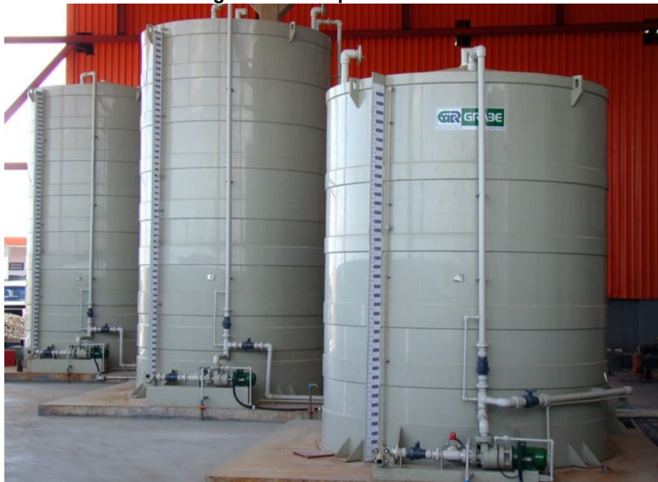
Figura 46 - Tanque de mistura.
