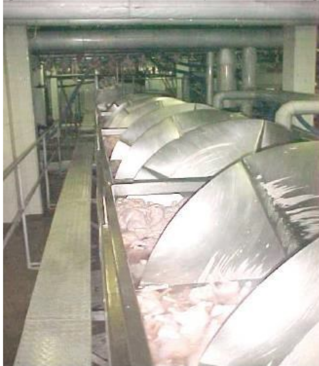
Figura 4 - Chiller de resfriamento por imersão em água
