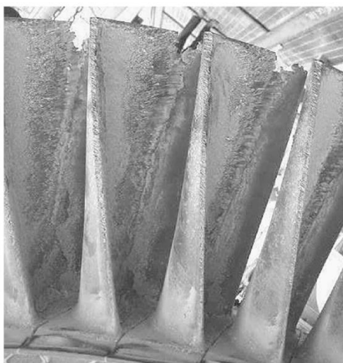
Figura 2. Palhetas danificadas pela erosão.
