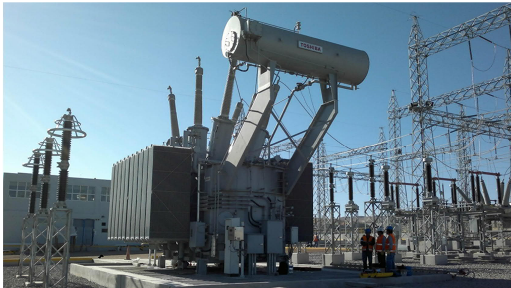
Figura 8 - Exemplo de transformador de potência.
