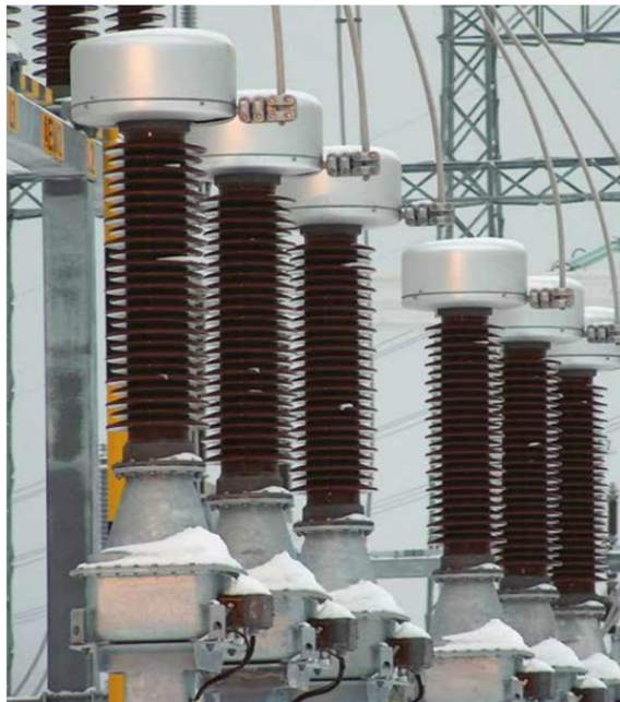
Figura 6- Exemplo de transformador de potencial.
