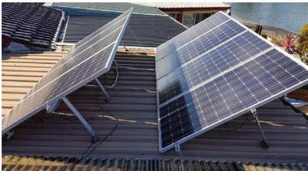
Figura 7: Painel Fotovoltaico sob o efeito de sombreamento.
