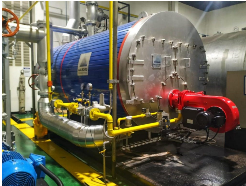
Figura 2 - Caldeira flamotubular convencional
