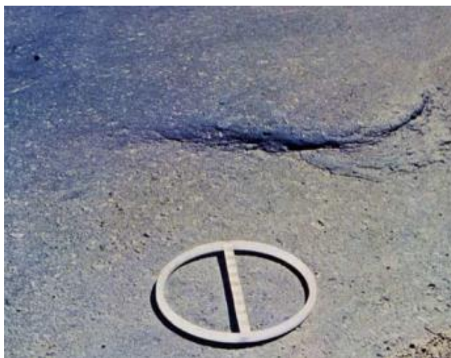
Figura 15: Escorregamento Fonte: DNIT (2003)
