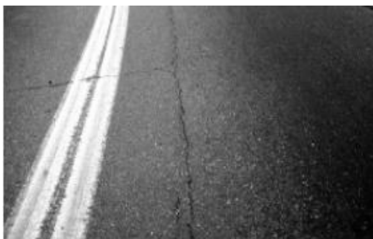
Figura 11: Trincas Longitudinais por reflexão Fonte: Fernandes Jr et al. (2011)
