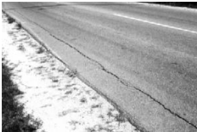
Figura 8: Trincas nos bordos em pavimento flexível Fonte: Fernandes Jr et al. (1999)
