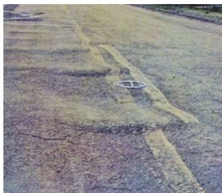
Figura 14: Ondulação Fonte: DNIT (2003)
