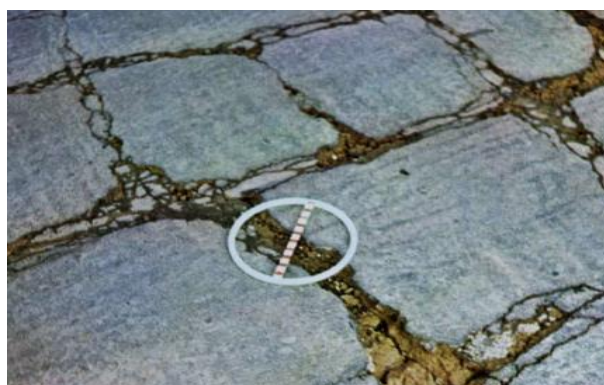
Figura 7: Trincas em blocos Fonte: DNIT (2003)
