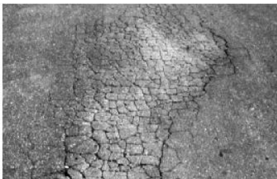
Figura 6: Trincas por fadiga em pavimento flexível Fonte: Fernandes Jr et al. (1999)
