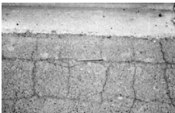
Figura 12: Trincas em blocos por reflexão Fonte: Fernandes Jr et al. (2011)
