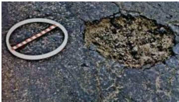
Figura 18: Panela ou Buraco Fonte: DNIT (2003)
