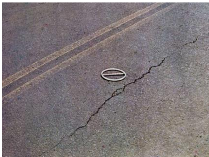
Figura 9: Trincas longitudinais em pavimento flexível Fonte: DNIT (2003)
