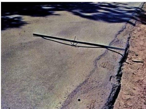
Figura 13: Afundamento de trilha de roda Fonte: DNIT (2003)
