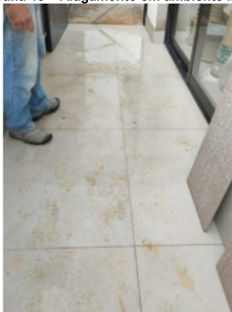
Fotografia 13 – Alagamento em ambiente interno
