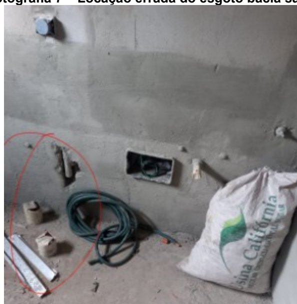
Fotografia 7 – Locação errada do esgoto bacia sanitária.
