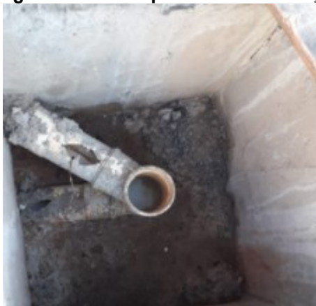
Fotografia 11 – Rompimento da tubulação
