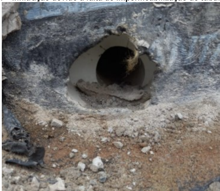
Fotografia 14 – Infiltração devido à falta de impermeabilização de tubulação
