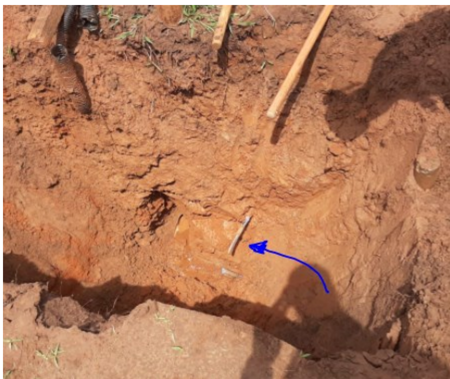
Fotografia 12 – Rompimento de mangueira PEAD entrada de água
