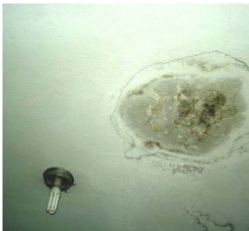
Fotografia 5- Mancha característica de vazamento no sistema de esgoto sanitário
