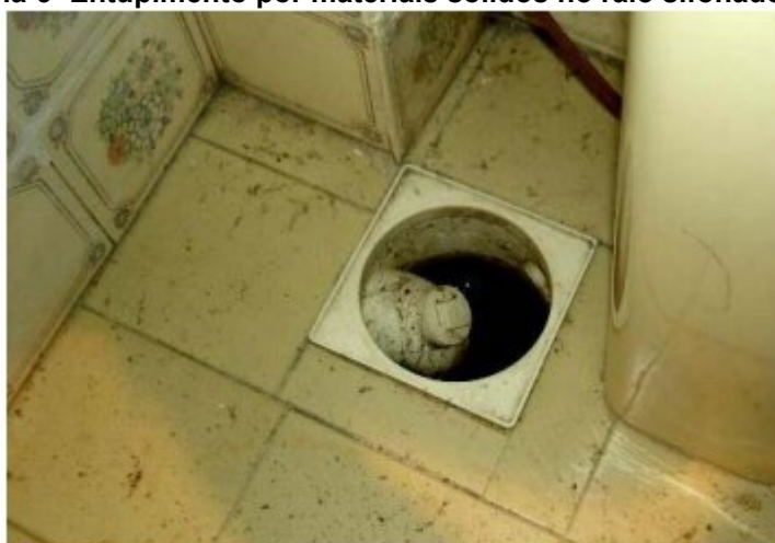
Fotografia 6- Entupimento por materiais sólidos no ralo sifonado
