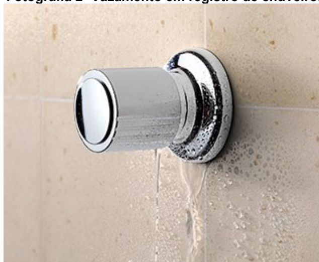
Fotografia 2- Vazamento em registro de chuveiro.
