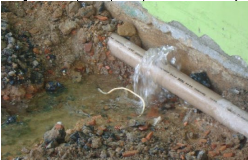
Fotografia 4 - Rompimento por choque mecânico em tubulação
