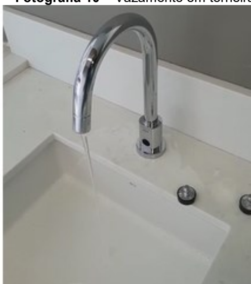
Fotografia 10 – Vazamento em torneira.
