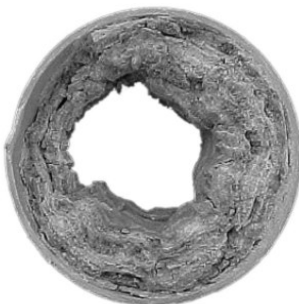
Fotografia 3 - Incrustação da tubulação
