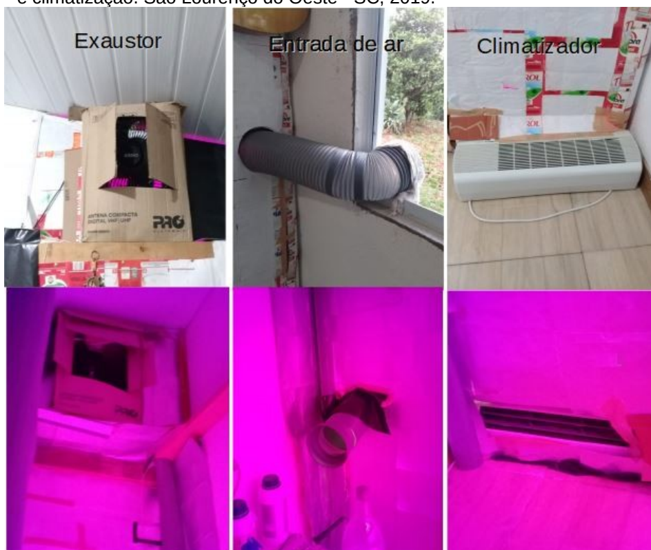
Figura 1 – Ambiente de produção indoor , com detalhes para saídas e entradas de ar para ventilação e climatização. São Lourenço do Oeste - SC, 2019.
