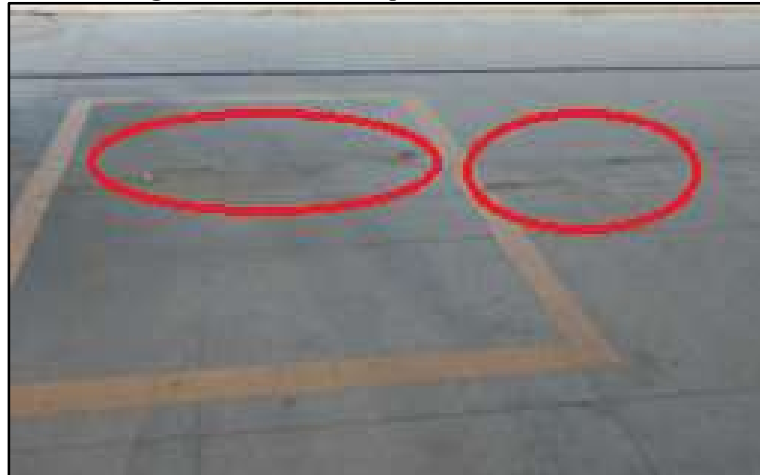
Figura 23 – Fissuras na pista de abastecimento
