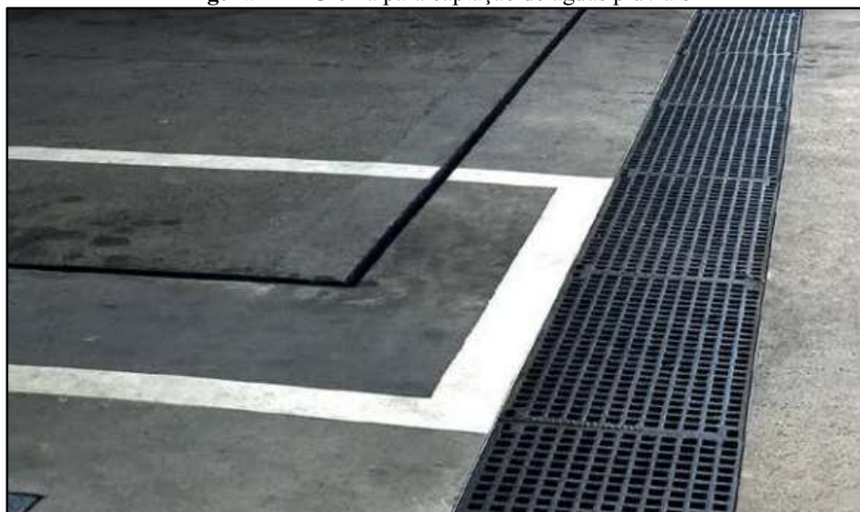
Figura 21 – Grelha para captação de águas pluviais
